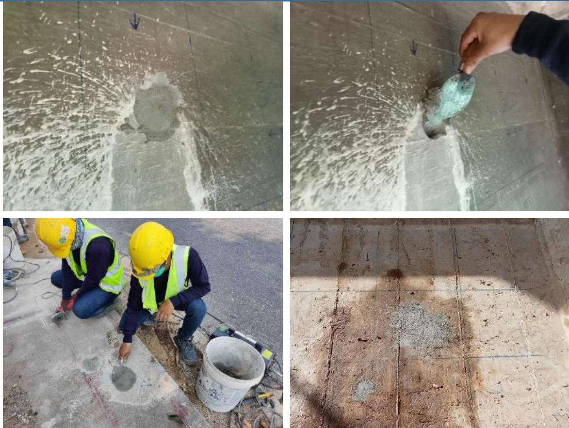
รูปที่ 9-9 รูปการซ่อมคืนสภาพจากการเก็บวัสดุทดสอบกำลังคอนกรีต
