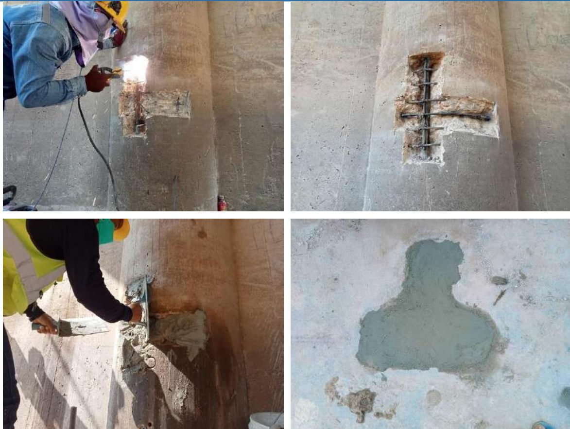
รูปที่ 9-11 รูปการซ่อมคืนสภาพจากการเก็บวัสดุทดสอบกำลังเหล็กเสริม
