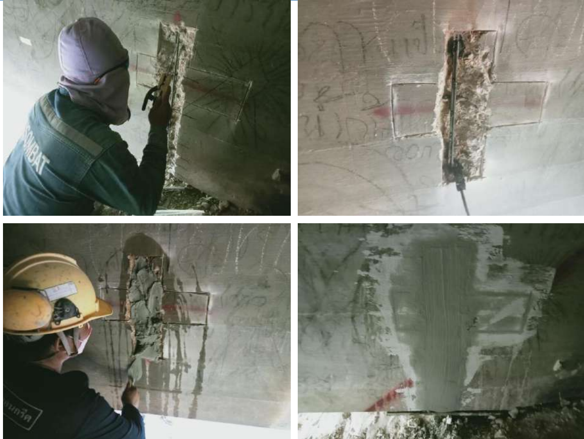
รูปที่ 7-11 รูปการซ่อมคืนสภาพจากการเก็บวัสดุทดสอบกำลังเหล็กเสริม
